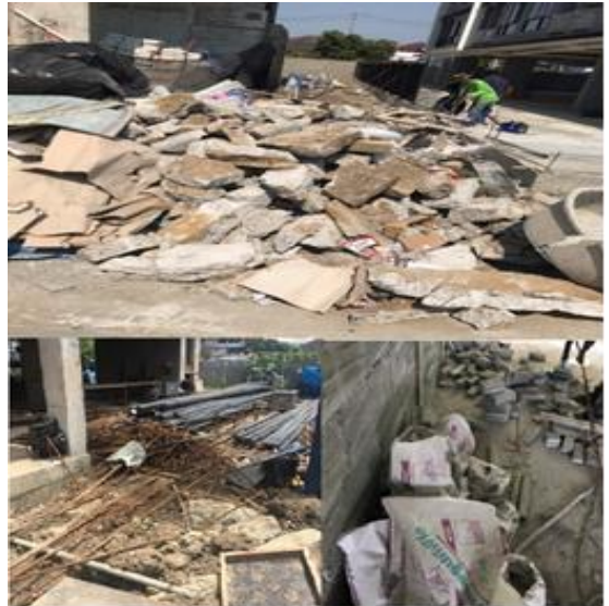
รูปที่ 1 ลักษณะของเสียที่เกิดขึ้นบริเวณอาคารก่อสร้าง (จังหวัดนนทบุรี)
