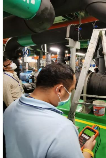
รูปที่ 3 การตรวจวัดอัตราการไหลของน้ำเย็นภายในท่อของระบบทำน้ำเย็น
